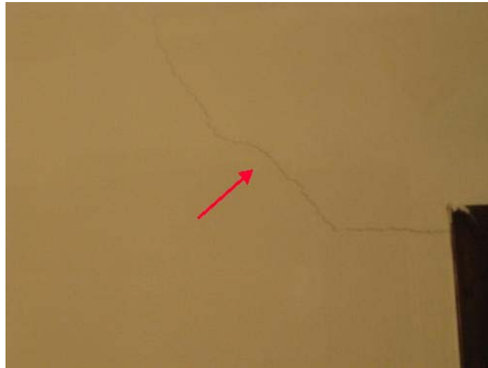
Drywall crack SE bedroom
